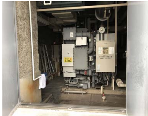
ガス吸収式冷温水機
