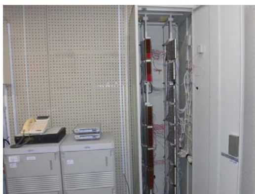
老朽化した電話交換機
